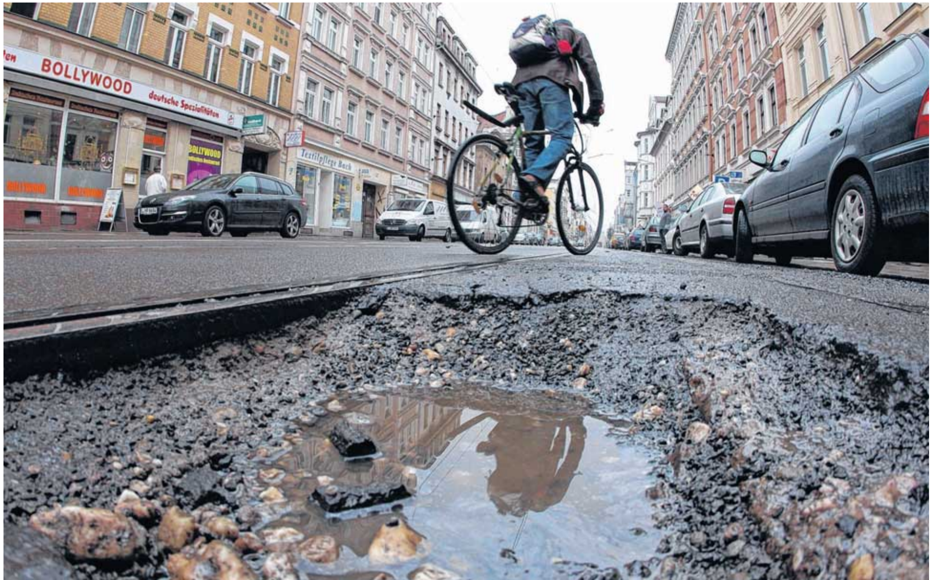
Dieser Radfahrer tut gut daran, das riesige Schlagloch auf der Zschocherschen Straße in Plagwitz weit zu umfahren. LVZ-Leser Hans Rennert hat das Problem auf die Tagesordnung gesetzt; heute wollen die Leipziger Verkehrsbetriebe den Schaden beheben.
