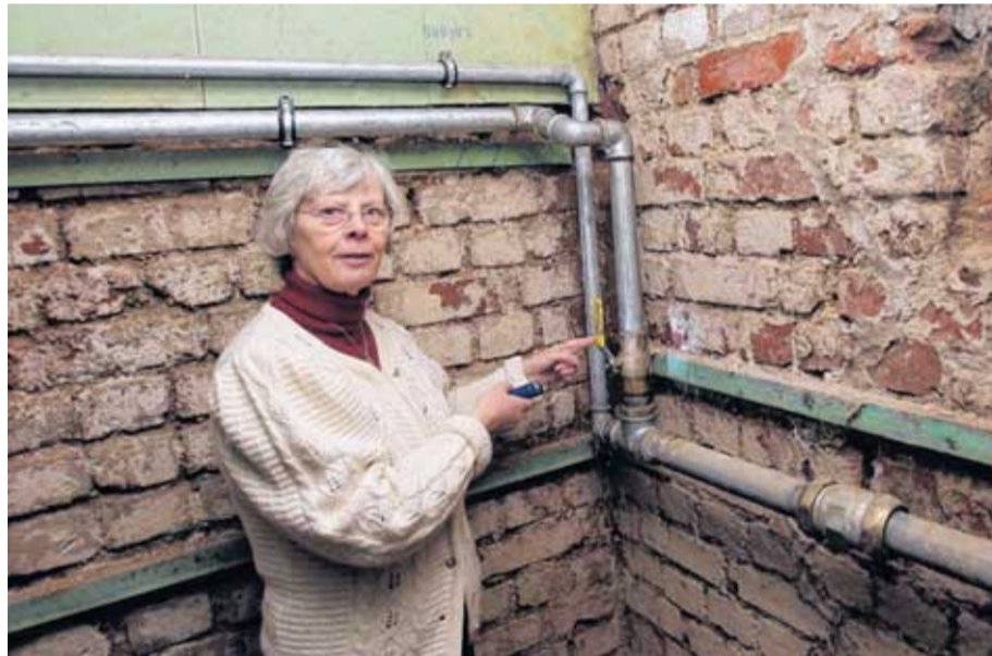
Vereinschefin Monika Schöpe am Tatort: Hier haben Diebe das Gasrohr abgesägt. Ein Ersatz ist inzwischen installiert – sicherheitshalber nicht aus Kupfer.
